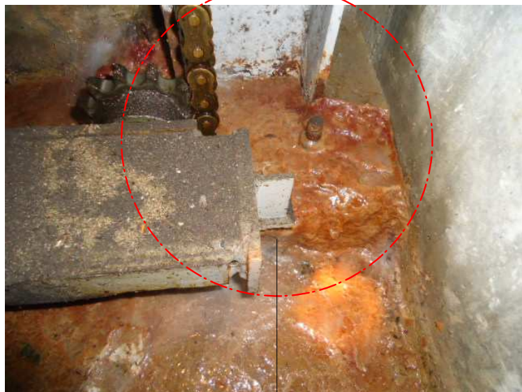
■ 発錆部地下1階駐脚 - 写真6
