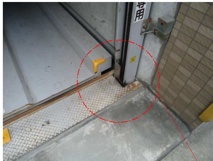
■ 発錆部1階 - 写真2
