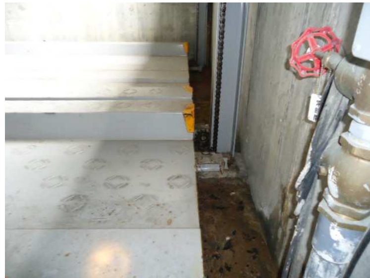
■ 発錆部地下1階釜場まで - 写真7
