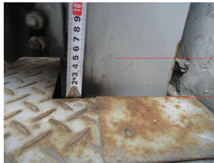
■ 発錆部1階詳細 - 写真3
